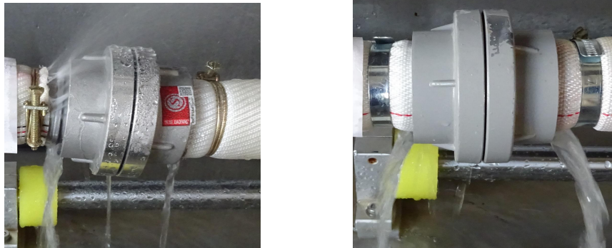
图10 水带与消防接口连接部位在试验压力下有泄漏现象
